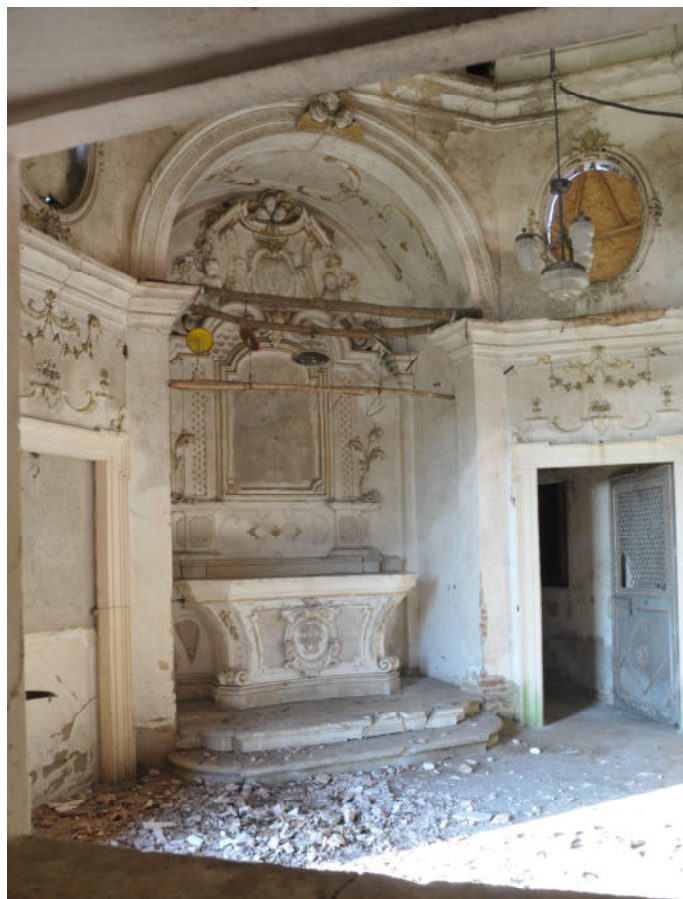
L'interno con l'altare barocco; sul pavimento parte del soffitto caduto
