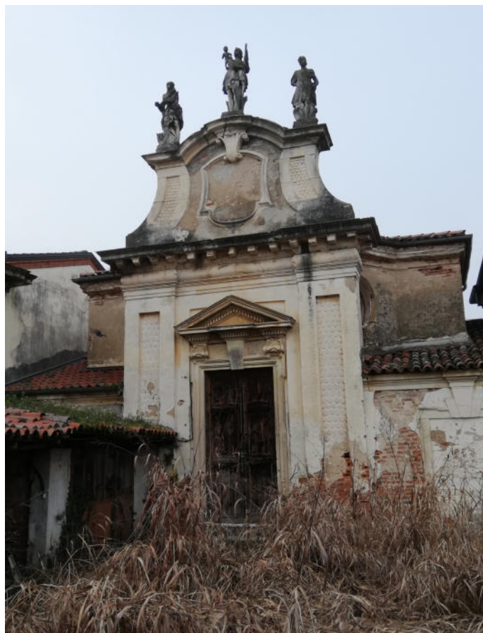
Condizione attuale dell’ oratorio (foto Maurizio Zanarella)
