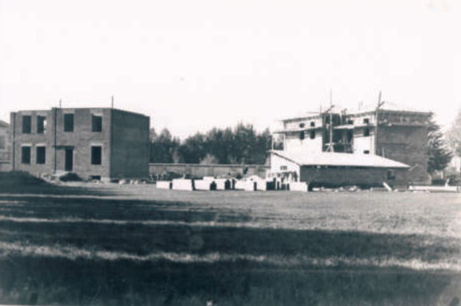
Il cantiere per la costruzione delle “case Fanfani” nell'ex campo sportivo comunale
